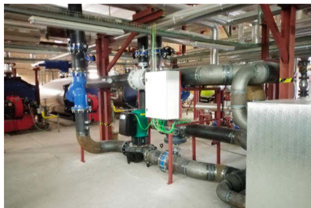
Sala de calderas.
